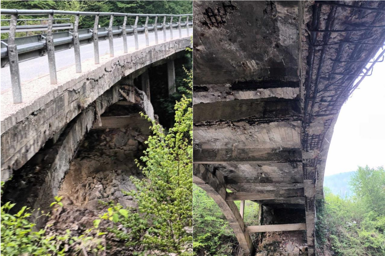
Slika 5: Trenutno stanje mosta na rijeci Drinjači
